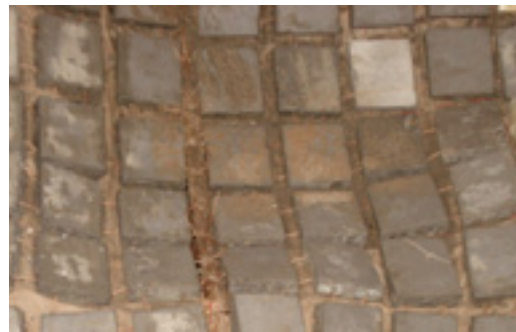
模型护滩带中部塌陷照片
