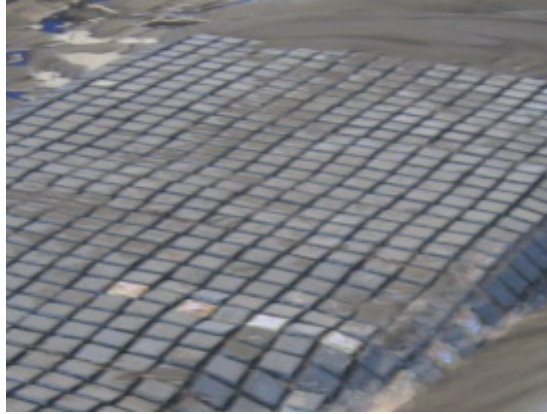
模型护滩带中部塌陷照片
