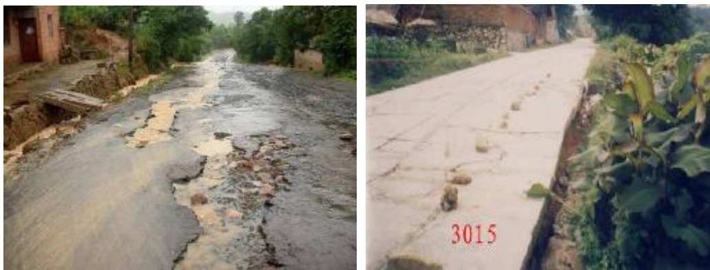
图 2.2-1 2007 年 9 号台风“圣帕”期间公路路基沉陷
